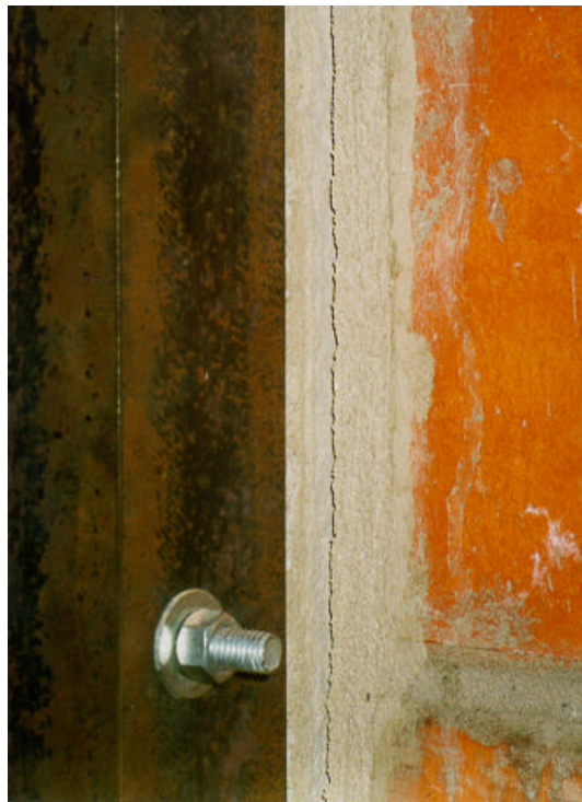
Figura 16 – Detalhe da fissura de interface entre parede e pilar de concreto observada no ensaio.
