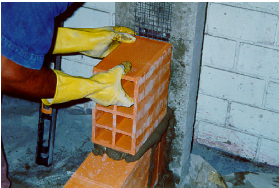
Figura 25 - Assentamento do bloco de 25 x 25 cm na extremidade da parede com os vazados na horizontal para receber a argamassa de colocação da tela. Observe-se o uso da cantoneira de 10 cm fixada com dois pinos.
