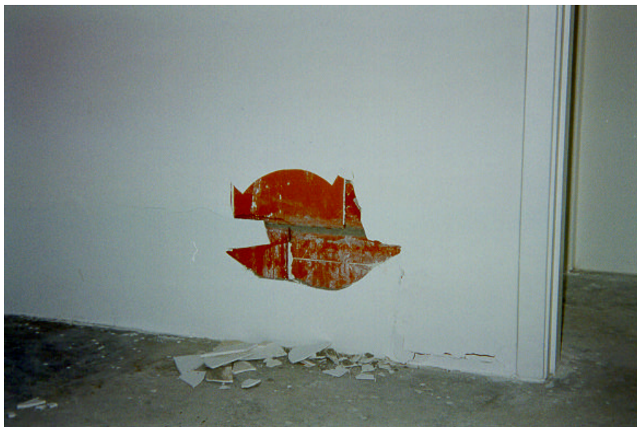
Figura 2 – Detalhe de ruptura das fiadas inferiores de uma parede de vedação que denota o surgimento do efeito de arco. Este efeito provoca a concentração de esforços nas regiões próximas aos apoios do elemento de suporte.
