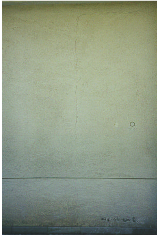
Figura 3 – Aspecto geral de uma fissura de interface entre parede de alvenaria e pilar. Esta manifestação ocorre em situações de deslocamento significativas dos elementos de apoios das paredes, como por exemplo, nas estrutura dos primeiros pavimentos dos edifícios de múltiplos andares, nas lajes e vigas de baixa relação altura-vão e nos balanços. Nestes casos o emprego de reforços adequados pode prevenir o problema.
