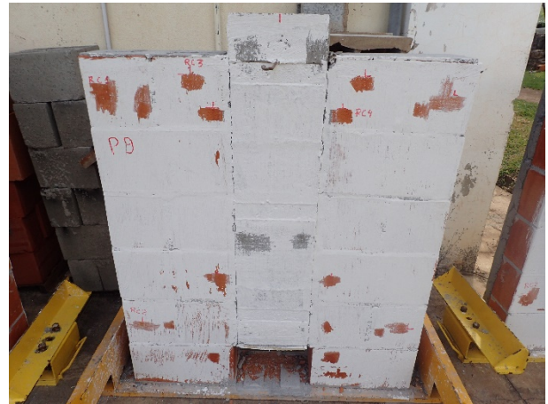
Figura 44 - Ruptura da interface entre alvenaria e pilar de concreto
