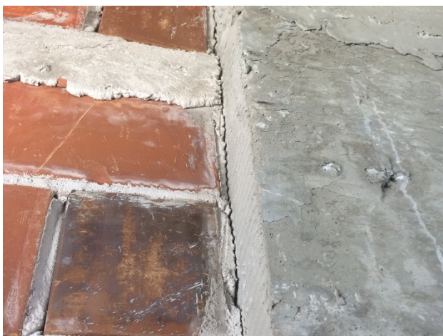
Figura 27 - Fissura na interface alvenaria-pilar
