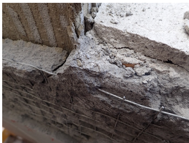
Figura 53 - Fissura interna contornando a tela metálica
