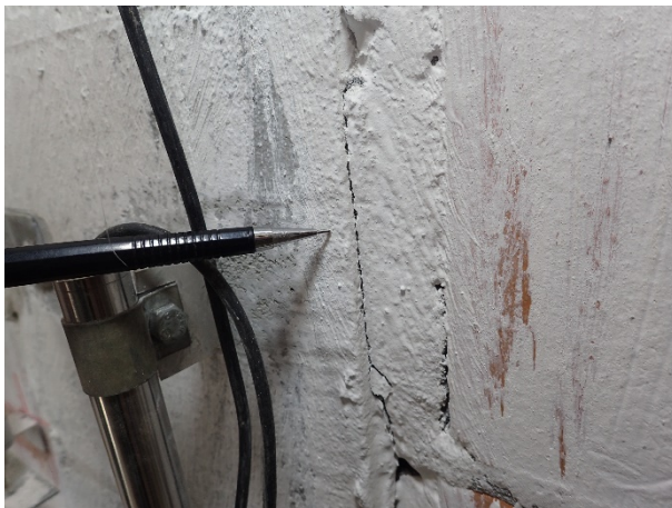
Figura 41 - Surgimento da fissura
