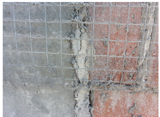
Figura 28 - Fissura na interface alvenaria-pilar
