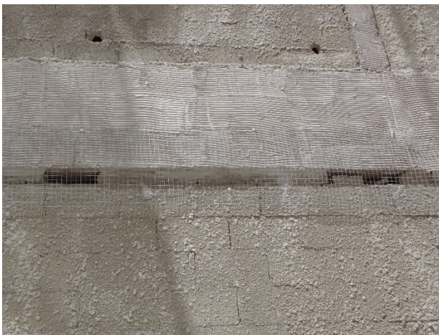
Figura 1 - Fixação superior da alvenaria com mau preenchimento
