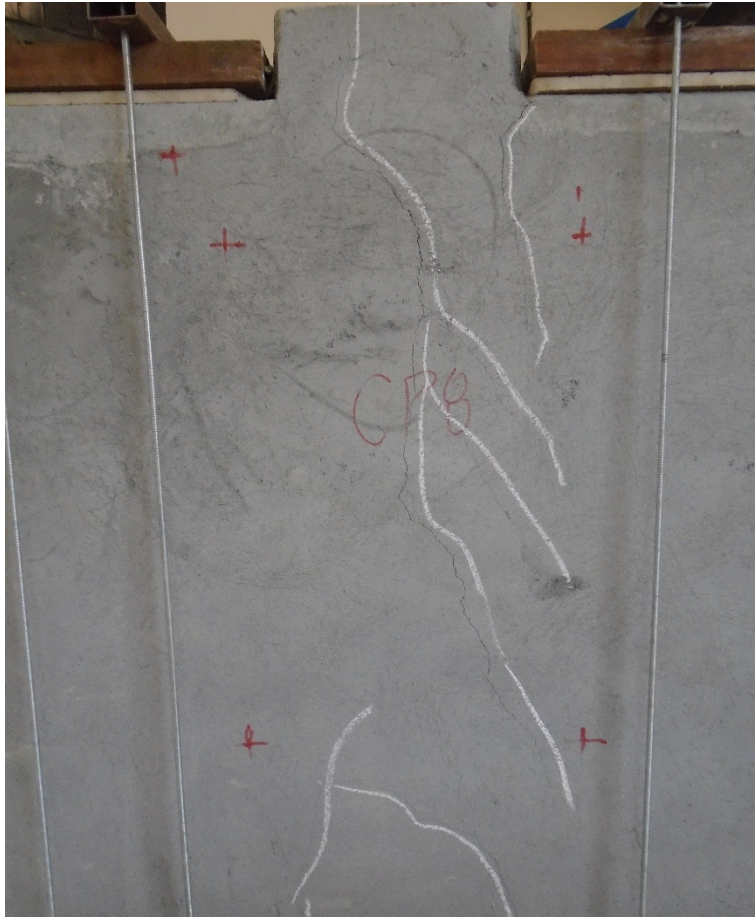
Figura 36 - CP após ruptura - Parede 8
